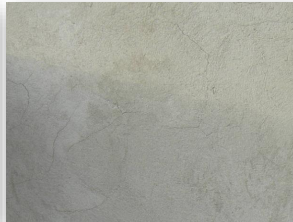
Cavillature - fessurazioni da ritiro
