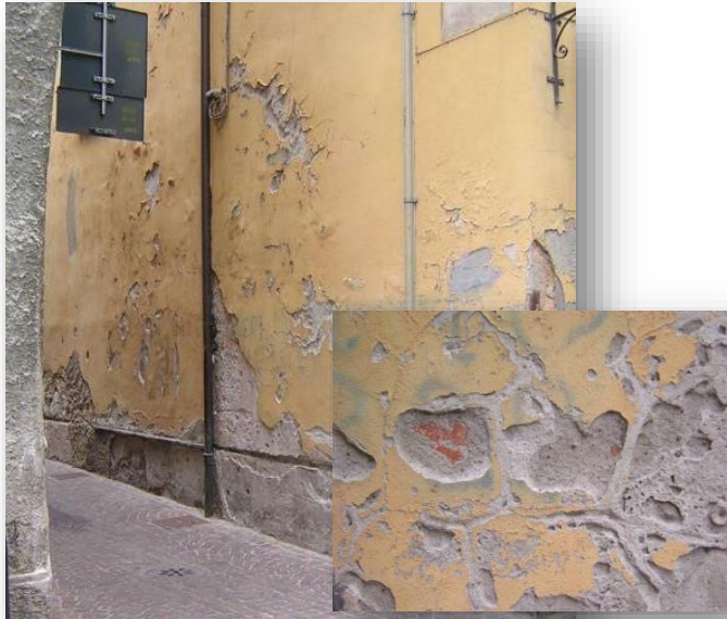
Umidità di risalita
